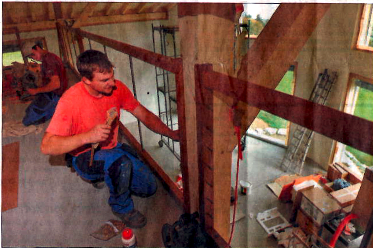
Armin Käslin von der Firma Ambauen Treppen Beckenried montiert im Haus in Giswil ein Geländer. BILDER C. GLANZMANN
