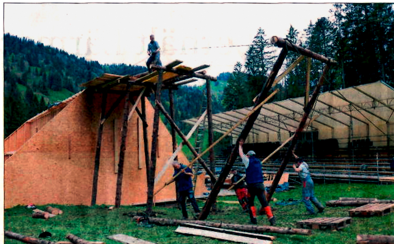
Mit vereinten Kräften wird am Bühnenbild gearbeitet. Während der Hauptteil (links) von Holzbaulehrlingen aufgebaut wurde, erstellen Freiwillige die Fortsetzung.
